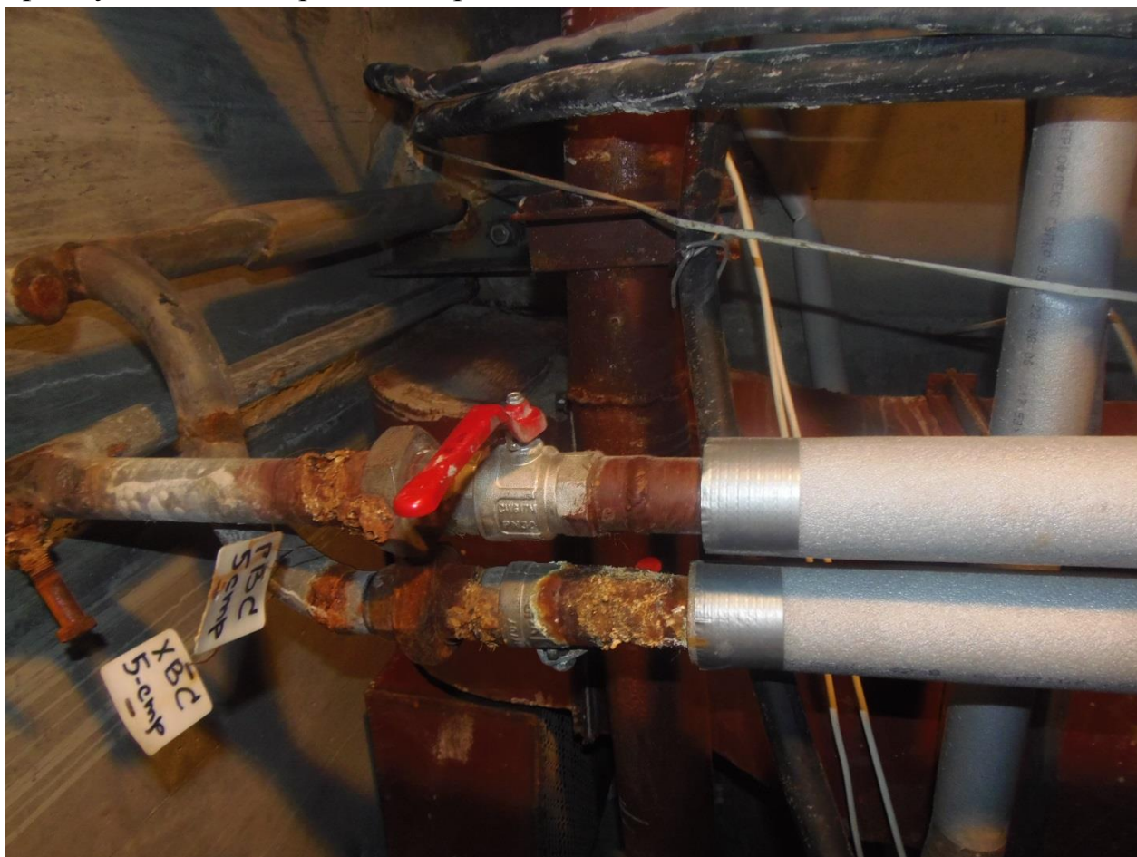
Фото. Следы коррозии.
